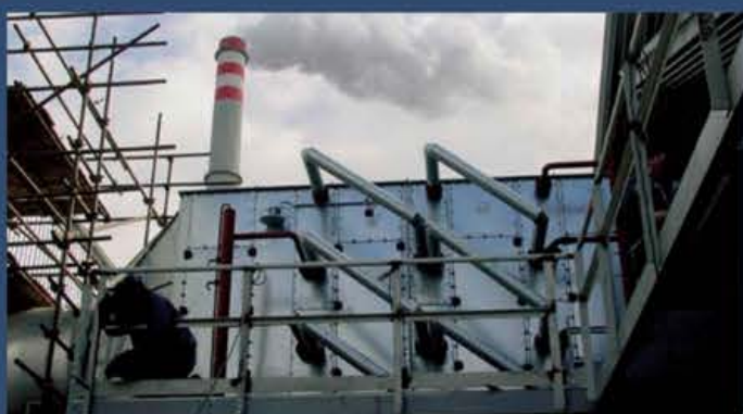
Pilzeńska cieplarnia-suszarnia biomasy Urządzenie klimatyzacyjne typu H/HL Wykonane bezramowo o wydajności około 100.000m 3 /godz.
